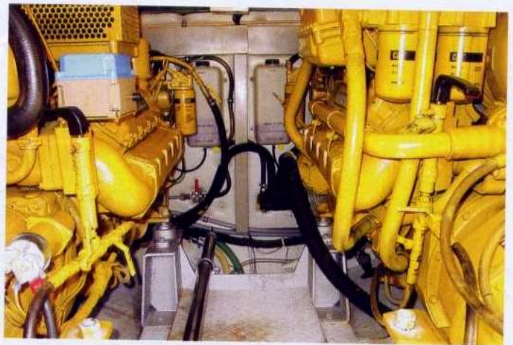
La sala macchine ha un volume sufficiente per consentire di effettuare operazioni sui motori in modo agevole.
